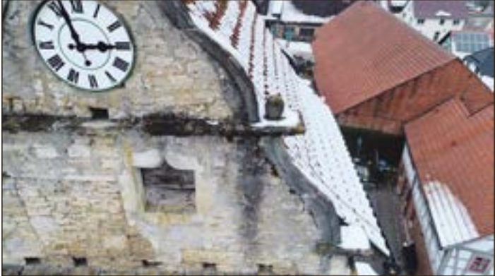
Ein Drohnenflug über dem Kirchturm brachte Gewissheit über den Schaden am Kirchturm. Foto: Baumann, Henfstädt
